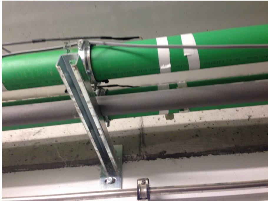
Abbildung 25: Montage der Temperatursensoren
