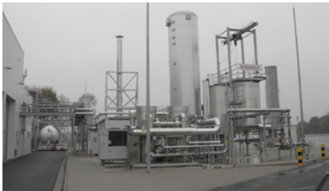
Das für die Methansynthese nötige CO 2 stammt aus der Aminwäsche, mit der aus Abfällen hergestelltes Biogas zu Biomethan aufbereitet wird.
