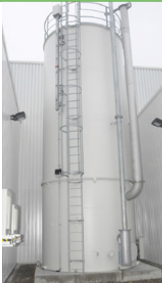
Dieser Tank speichert den elektrolytisch erzeugten Wasserstoff.
