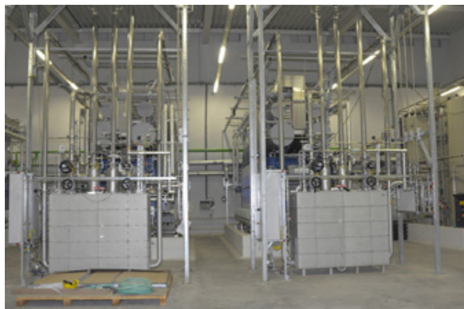
Elektrolyseure mit einer elektrischen Leistung von 2 MW nutzen überschüssigen Ökostrom dazu, Wasserstoff aus Wasser abzuspalten.
