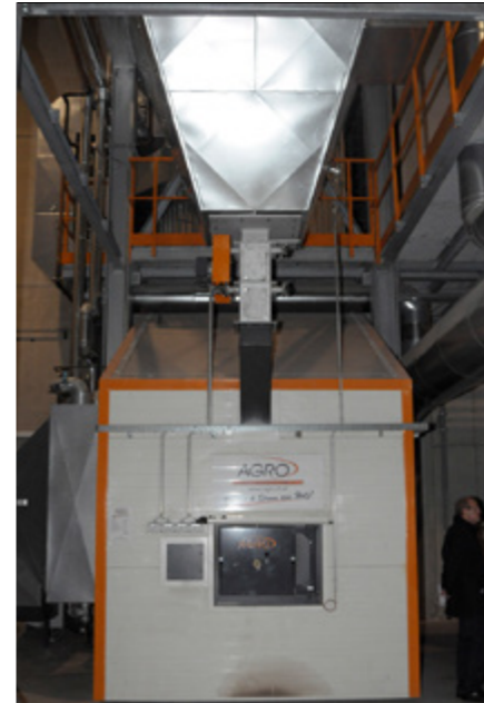
Zwei solcher Holzöfen mit einer Leistung von 5 MW liefern Wärme für die Grund- und Mittellast.
