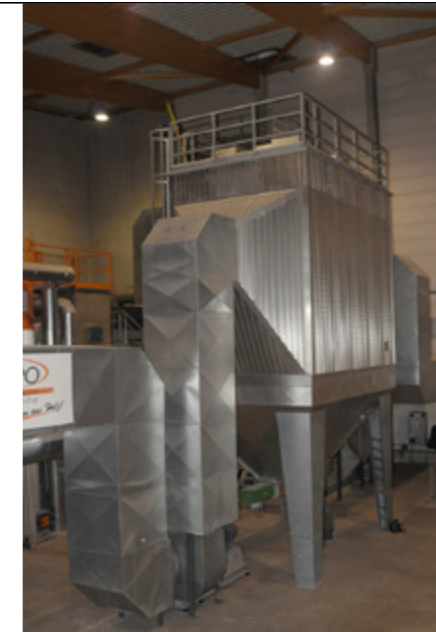
Dieser Elektrofilter scheidet schädliche Staubpartikel aus dem Abluftstrom ab.
