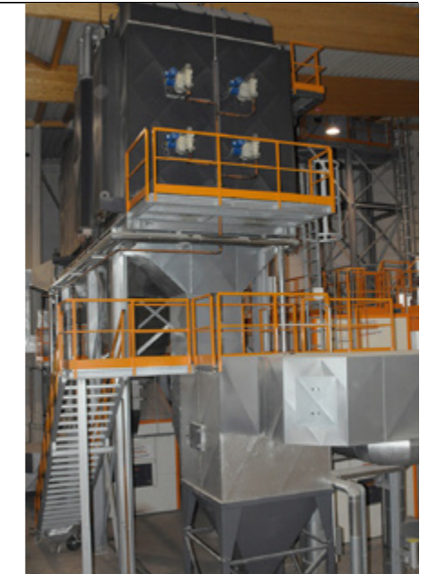
In diesen Kesseln verdampft das für die Stromerzeugung verwendete Thermoöl.
