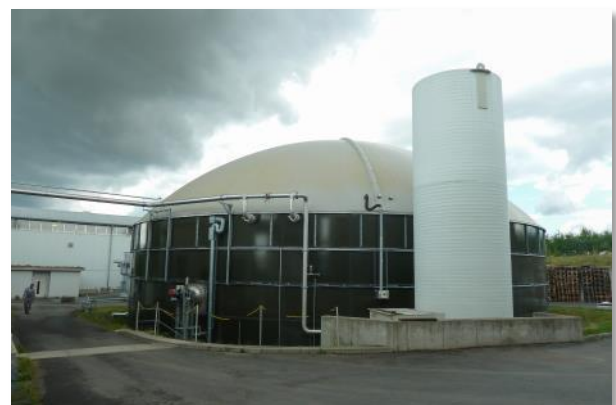
Nachgärbehälter der Biogasanlage mit Gasspeicher im Dach und Entschwefelung (weißer Turm im Vordergrund)
