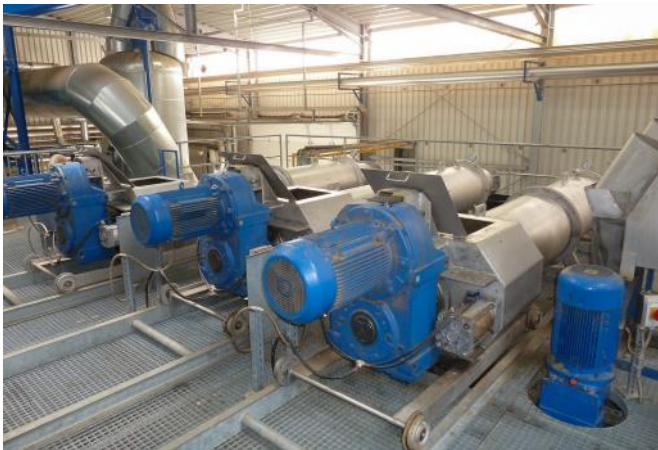
Siebpressen zur Entwässerung der Grasfasern
