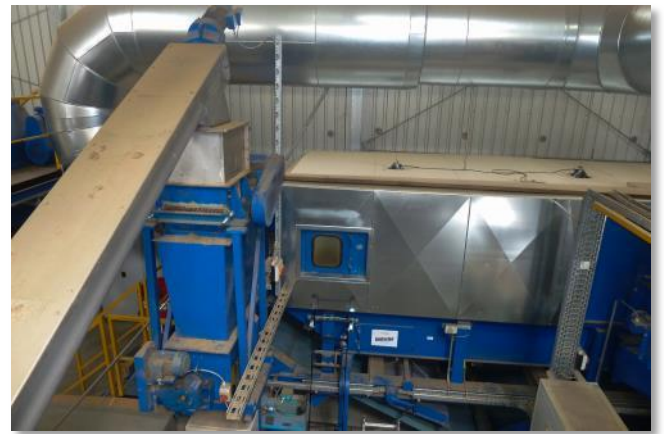
Befüllstation und Beginn des Faser-Bandrockners
