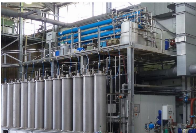
Wasseraufbereitungsanlage zur Eigenversorgung. Im Vordergrund die Ultrafiltration (stehend) und im Hintergrund oben (blau) die Umkehrosiose
