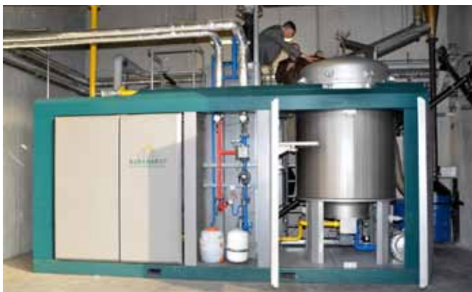
Zurzeit sind zwölf mit Holzpellets besetzte Burkhardt-Vergasermodule mit einer elektrischen Leistung von 180 kW in Betrieb.
