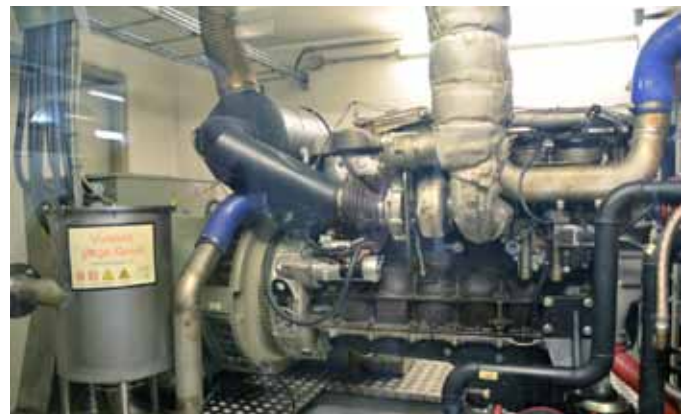
Jedem Vergaser ist ein eigenes Blockheizkraftwerk zugeordnet, welches aus dem Holzgas Strom und Wärme produziert.
