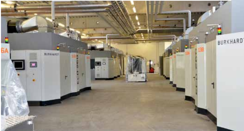
In der oberen Etage der Energiezentrale stehen diese Kabinen, in denen jeweils zwei Blockheizkraftwerke untergebracht sind.
